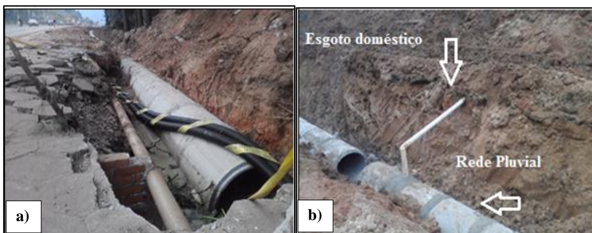
Figura 3 - efluentes domésticos e pluviais dispostos na mesma rede de drenagem.
