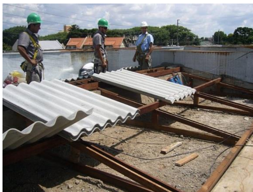
Figura 6 – Troca do telhado do hospital veterinário do campus agrárias da Universidade Federal do Paraná (Fonte: UFPR, 2013, n.p.)
