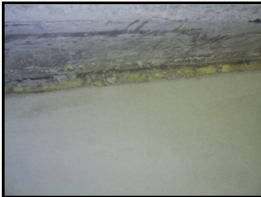
Detalhe da conexão elástica entre a parede e a laje de teto da Câmara
