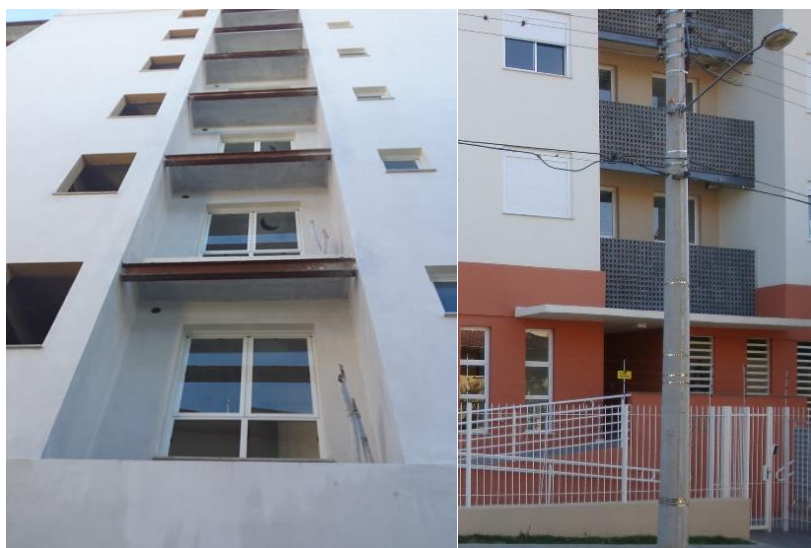
Figura 4.5 - Laje técnica reservado para as unidades externas dos splits e cobogós com função estética e de “esconder” unidades externas
