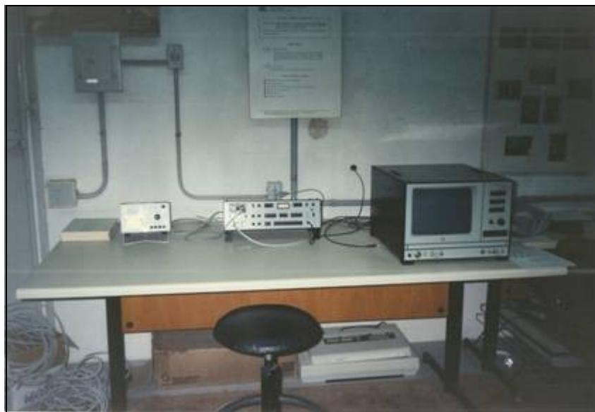
Figura 39 – Sala de Ensaios - LaTA
