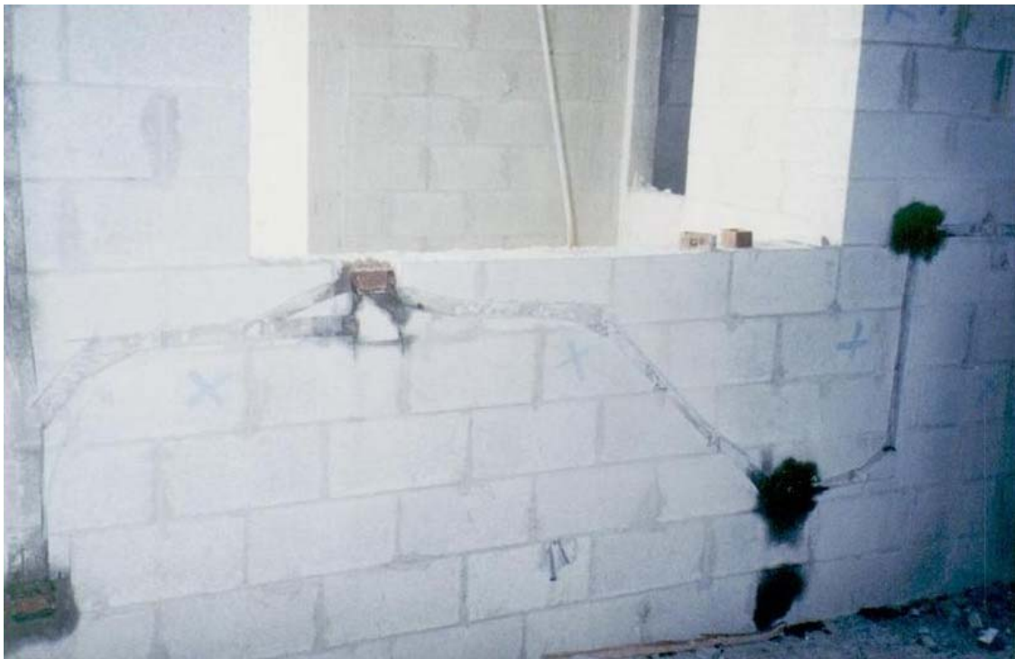
FIGURA 5.36 – Rasgos horizontais nas paredes para execução de instalações, prática inaceitável em se tratando de alvenaria estrutural. (SANTOS, 1998).
