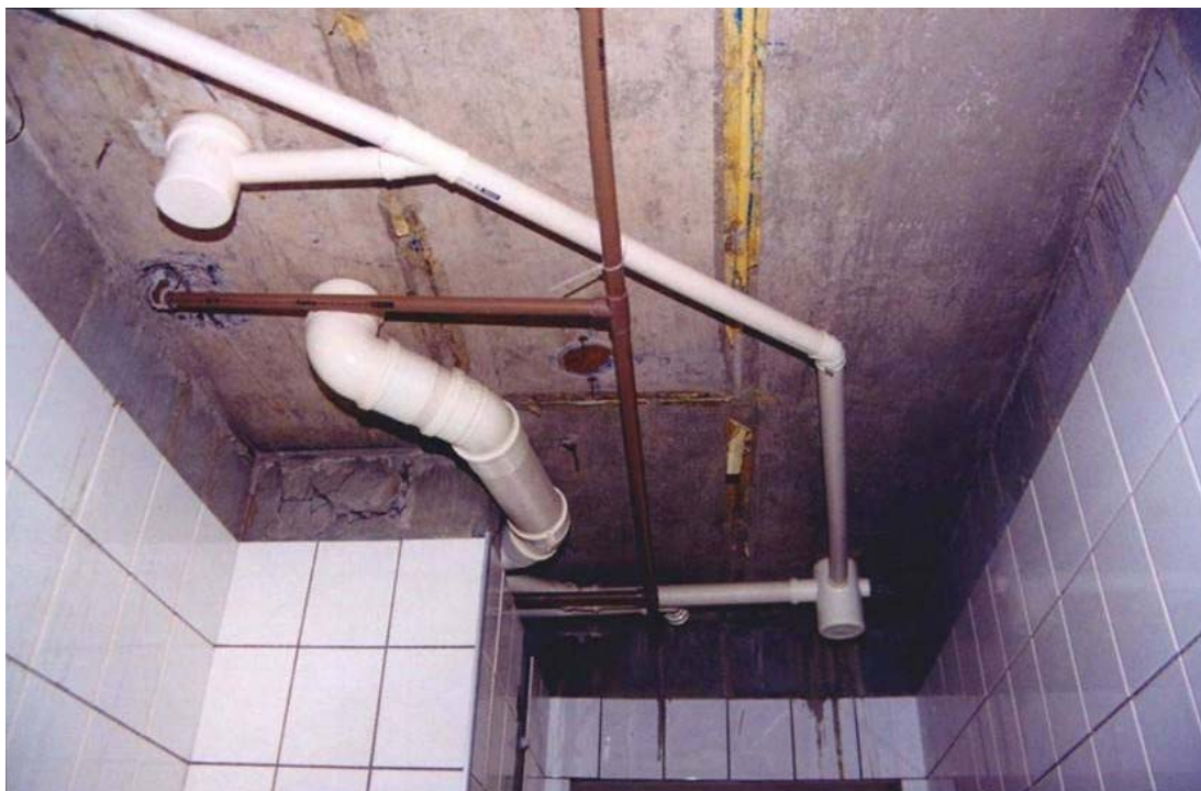
FIGURA 5.44 - Tubulação horizontal sob a laje, oculta por forro rebaixado (SANTOS, 2004).
