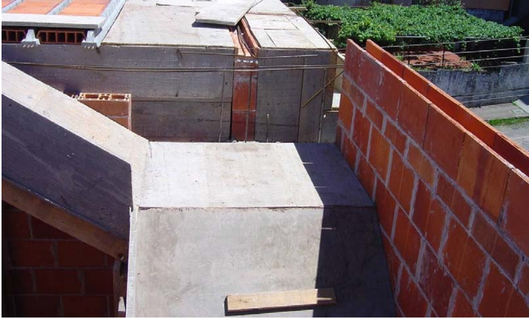
FIGURA 5.49 – Execução das formas de uma escada de concreto armado moldada in loco (SANTOS, 2004).
