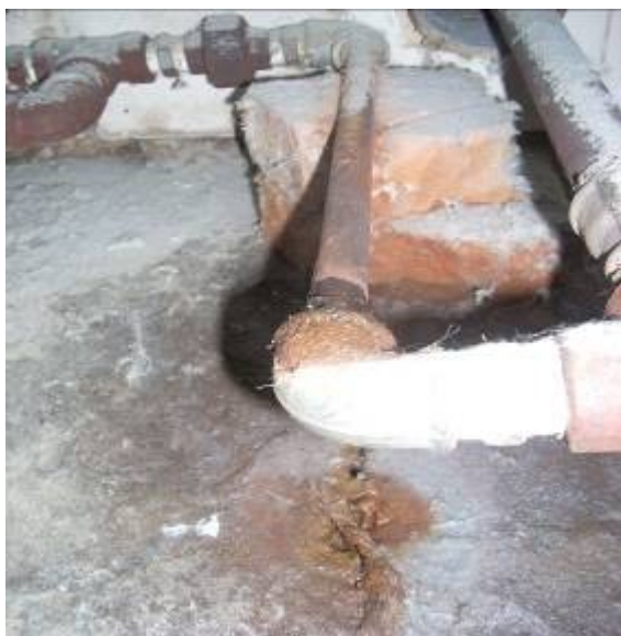
Figura 13 – Tubulação de vapor
