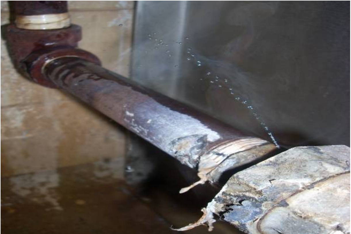
Figura 7 – Tubulações dentro da lavanderia com vazamentos e sem isolamento
