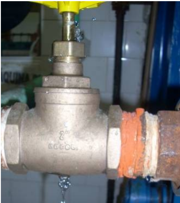
Figura 17 – Vazamento no registro
