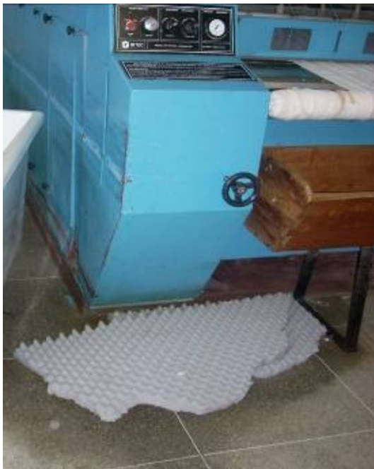
Figura 23 - Calandra vazando óleo
