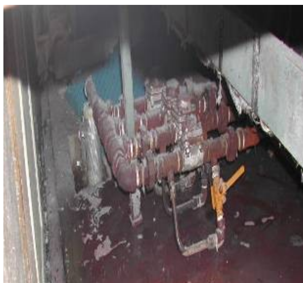
Figura 14 – Tubulações de vapor da calandra
