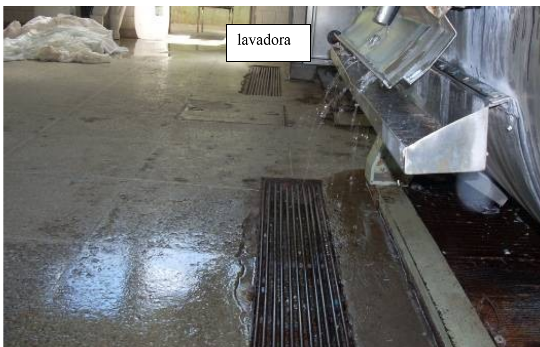
Figura 8 – Condições do piso
