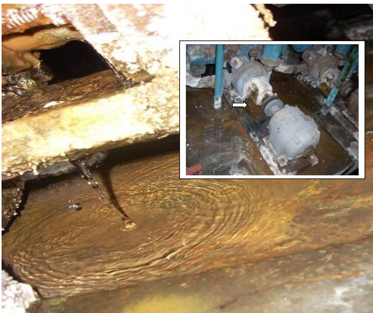
Figura 26 - Vazamento das bombas de água na área das caldeiras
