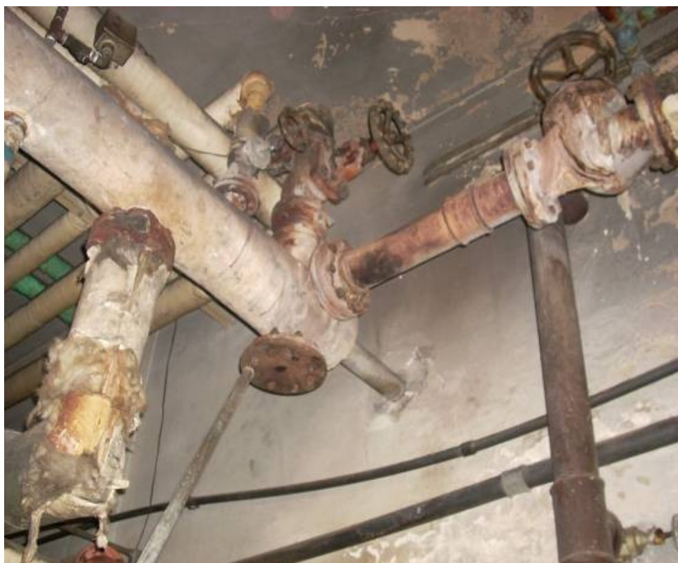
Figura 25 - Tubulações de vapor sem isolamento ou danificadas na área da caldeira
