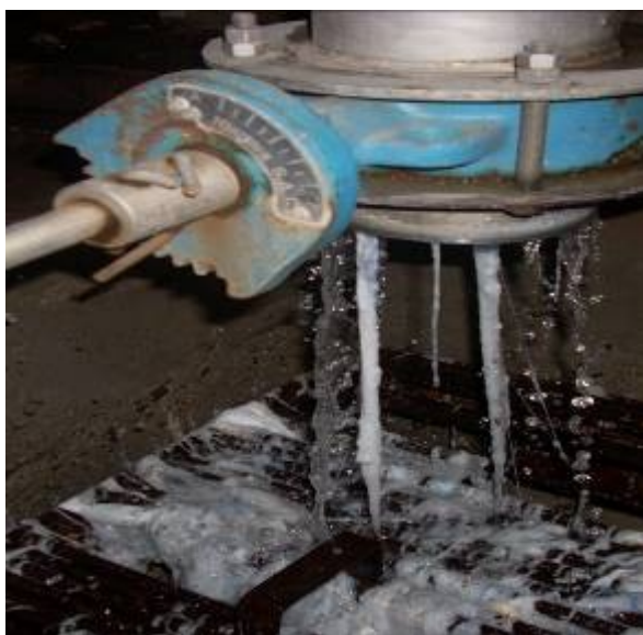
Figura 15 – Vazamentos nas lavagens
