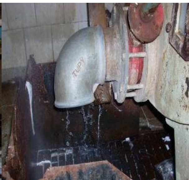
Figura 16 – Vazamentos nas lavagens
