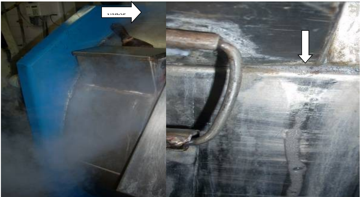
Figura 19 – Lavadora 2 vazando vapor Figura 20 – Emendas das lavadoras
