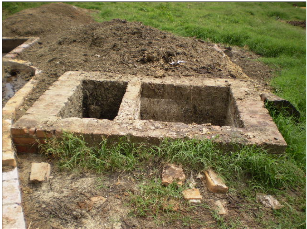
Figura 4.28 - Resíduos sólidos depositados sem qualquer tipo de proteção no abatedouro Tropeiro
