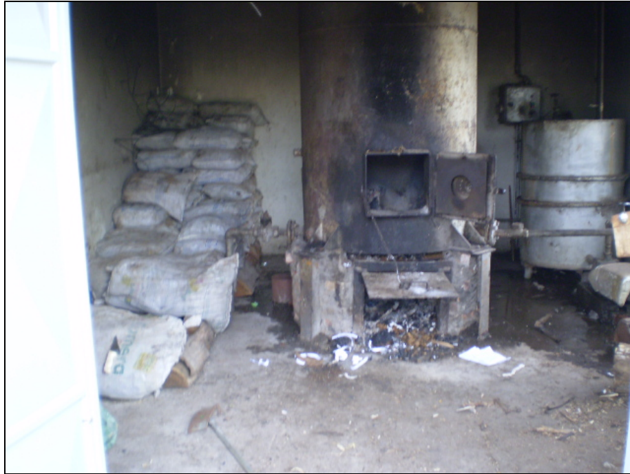
Figura 4.12 - Estoque de resíduos da graxaria para ser queimado na fornalha da caldeira
