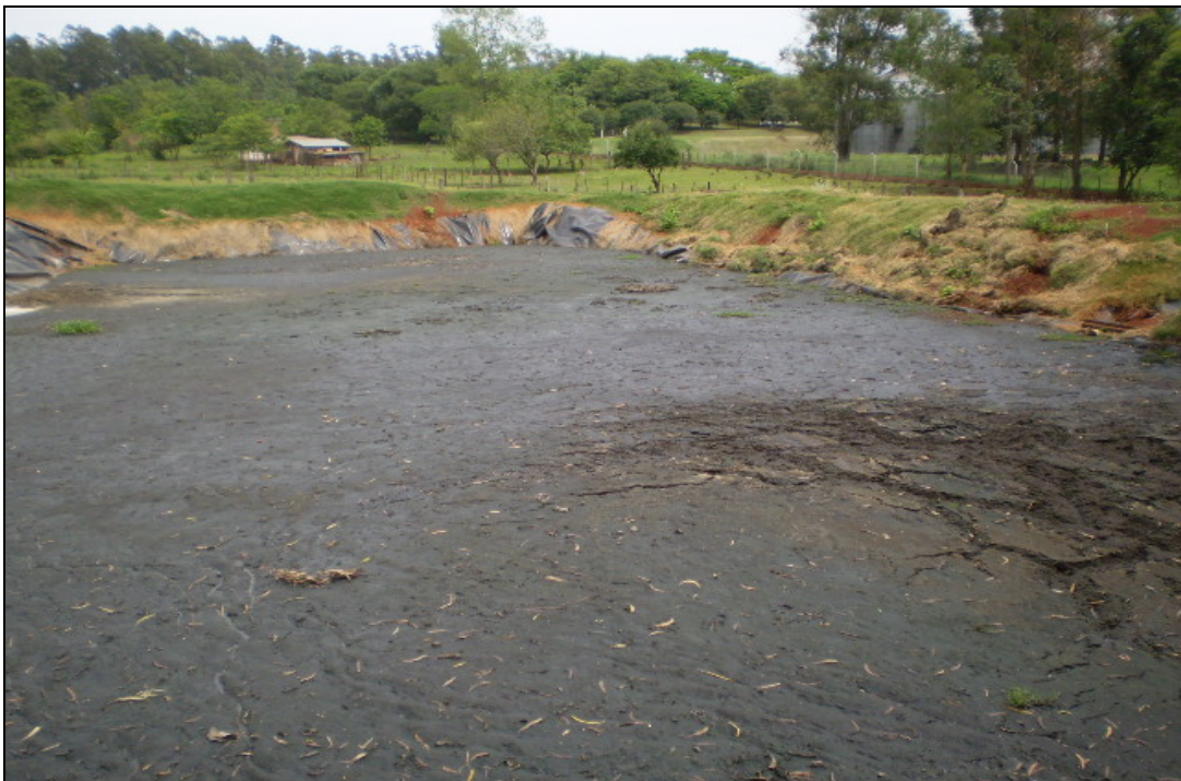
Figura 4.22 - Tanque de sedimentação impermeabilizado e com alta carga de material orgânico
