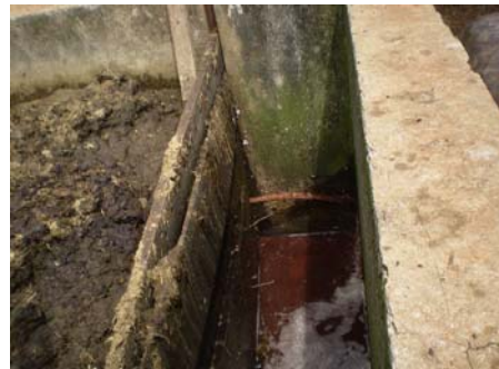
Figura 4.21 – caixa de esterqueira
