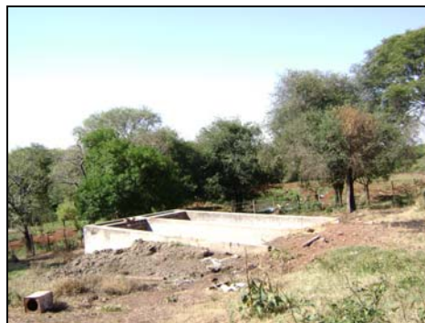
Figura 4.16 – Separador de sólidos (esterqueira)
