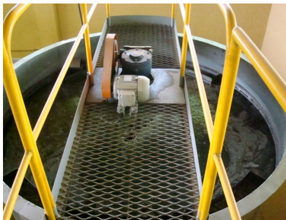
Figura 39 - Tanque receptor da ETE.
