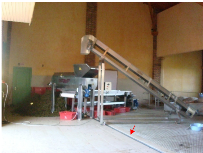
Figura 25 - Calhas para absorção dos efluentes da lavagem dos equipamentos. Fonte: Autora
