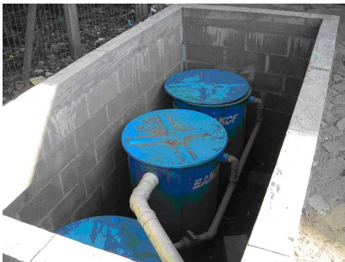
Figura 3 - Sistema de tratamento de água
