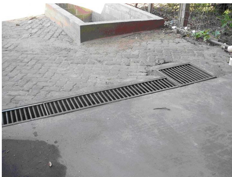
Figura 5 - Caixa de decantação a descoberto
