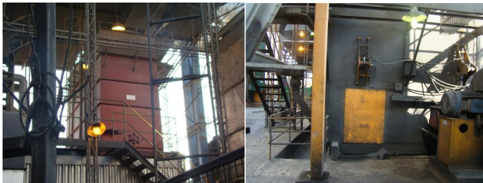
Figura 09: Reservatório de água e caldeira Fonte: Fotos reproduzidas com a autorização da Camil Alimentos S.A (2011)
