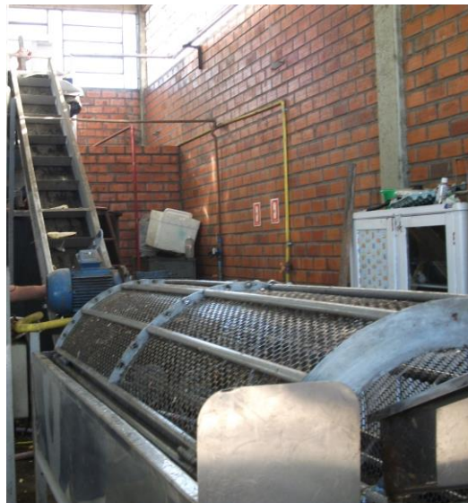
Figura 4.4 – Vista frontal da esteira transportadora que leva a matéria-prima do tambor de lavagem para o triturador
