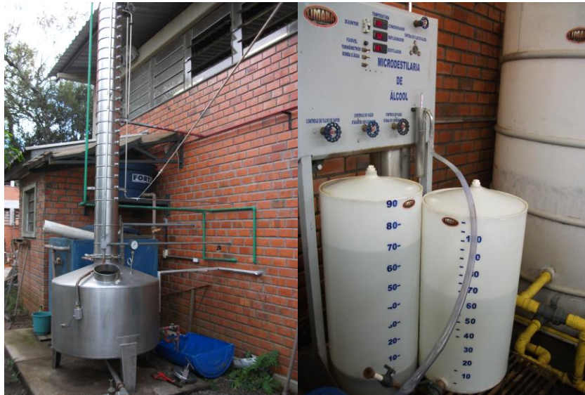
Figura 4.12 - Microdestilaria no sistema de batelada. A esquerda, do lado externo do prédio, a torre de destilação. A direita, na parte interna, os recipientes do álcool destilado
