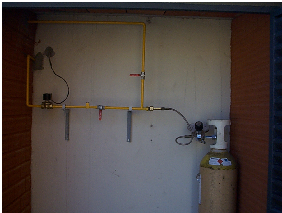
Figura 6.2 – Foto interno da central de gás.
