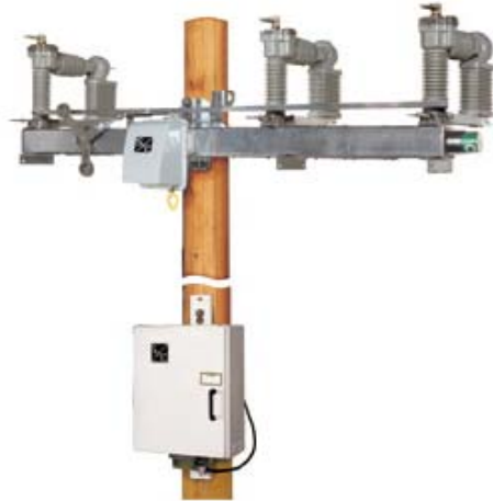
Figura 2.16 – Chave de manobras tripolar de operação remota.
