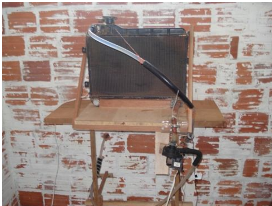
Figura 4.13 - Foto do sistema geotérmico interno
