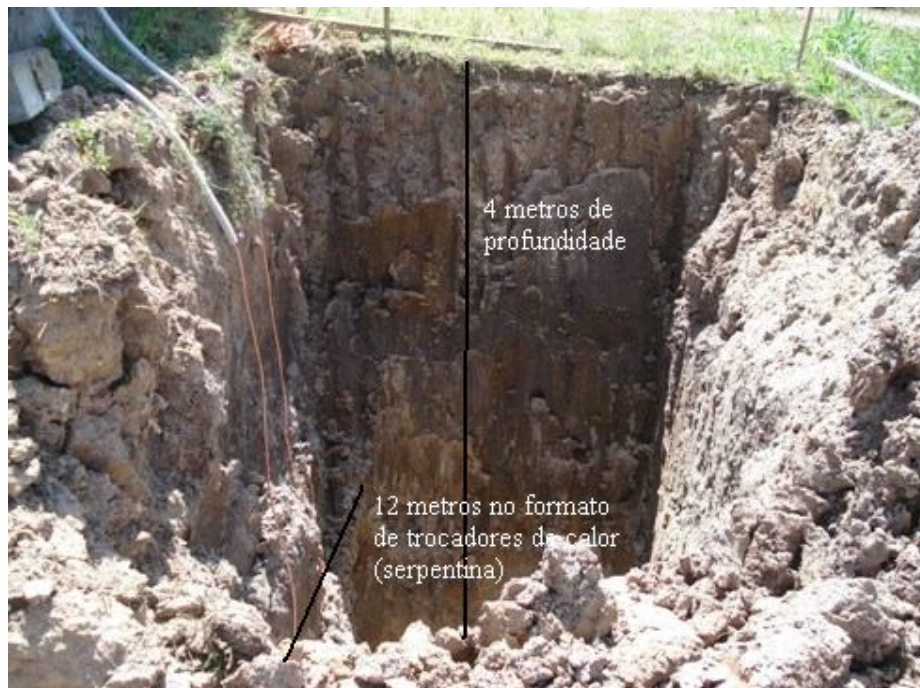
Figura 4.14 - Foto do sistema geotérmico, profundidade de 4 metros, e trocador de calor com 12 metros de comprimento (serpentina).
