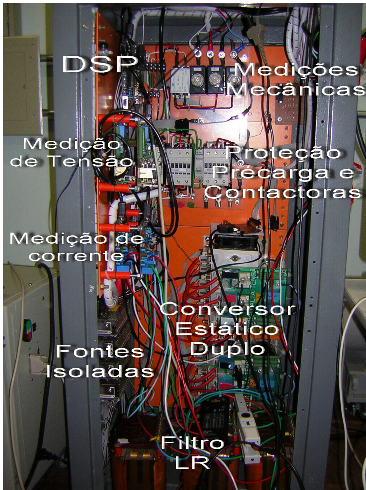
Figura 8-4 – Foto do Módulo de controle da MATRADA
