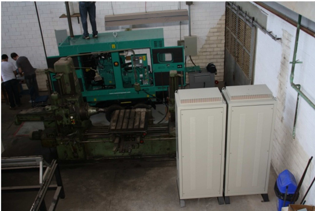
Figura 3.16 – Grupo motor gerador e conversores instalados no NAFA/UFSM
