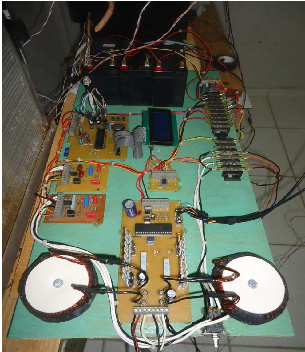
Figura A.1 – Circuitos utilizados no controle HCC e placa de aquisição de dados
