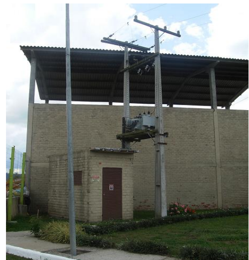
Figura 14 – Ponto de conexão com a rede elétrica de média tensão, que fornece energia ao CTR Caturrita
