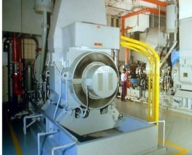
Figura 2 – Turbina a gás Fonte: Us Environmental Protection Agency (2015).
