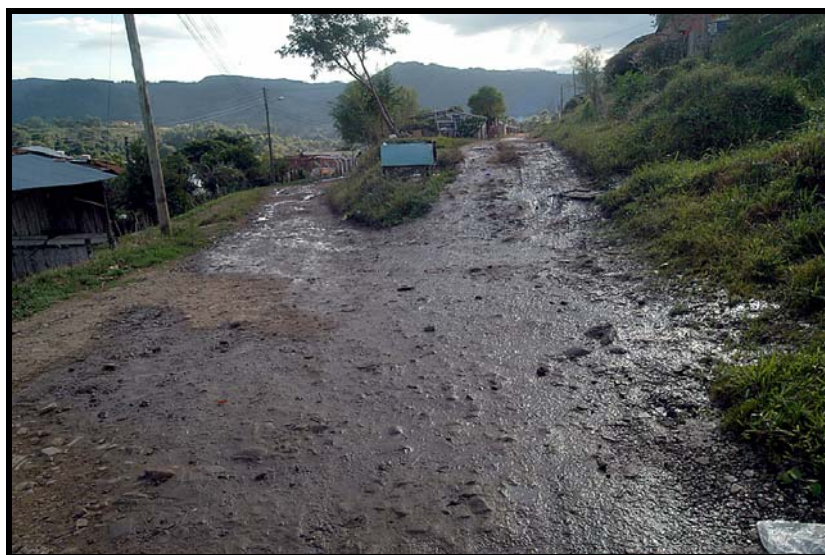
Figura 30 – Aspecto da má conservação das estradas em áreas de habitação. Microbacia do rio Vacacaí-Mirim, Santa Maria, RS. (Fonte: Guerra, 2004.)
