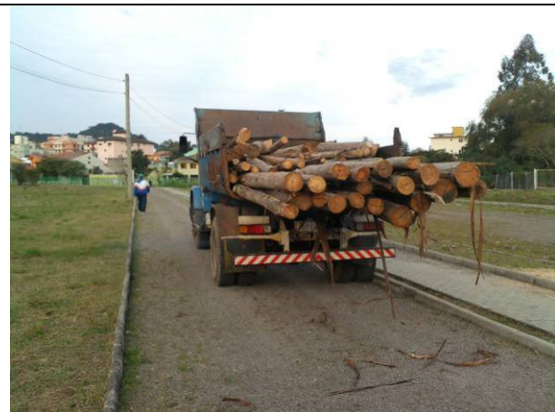
Transporte da madeira até o local da obra através da pista de caminhada do parque.
