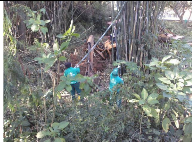
Corte das taquaras com moto poda e facão. Início da remodelagem do talude.
