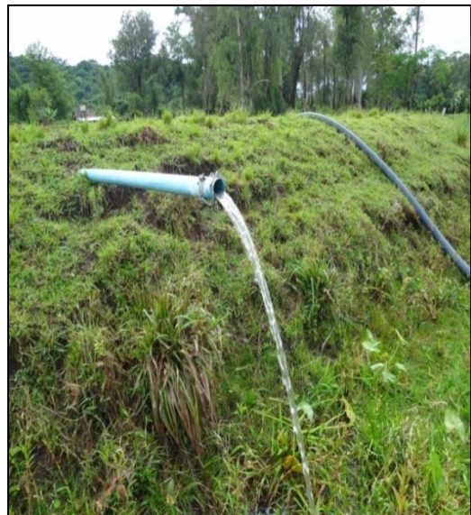
Figura 11 - Entrada de água por cano
