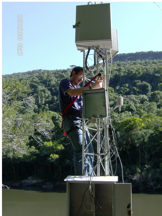
Figura 4.12: Manutenção de uma estação.
