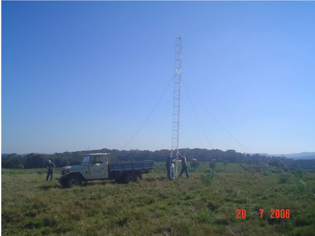
Figura 4.10: Instalação da estação de Veranópolis.
