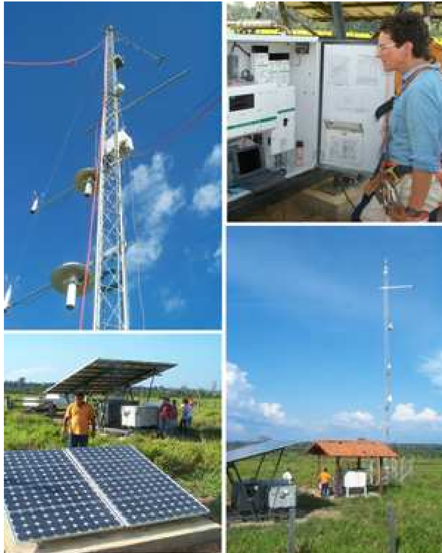
Figura 11: Mosaico do sítio Experimental, montagem da torre (acima à direita), quadro de comandos SunWize (acima à direita), painéis solares e banco de bateria (inferior à esquerda) e visão do conjunto (inferior à direita).
