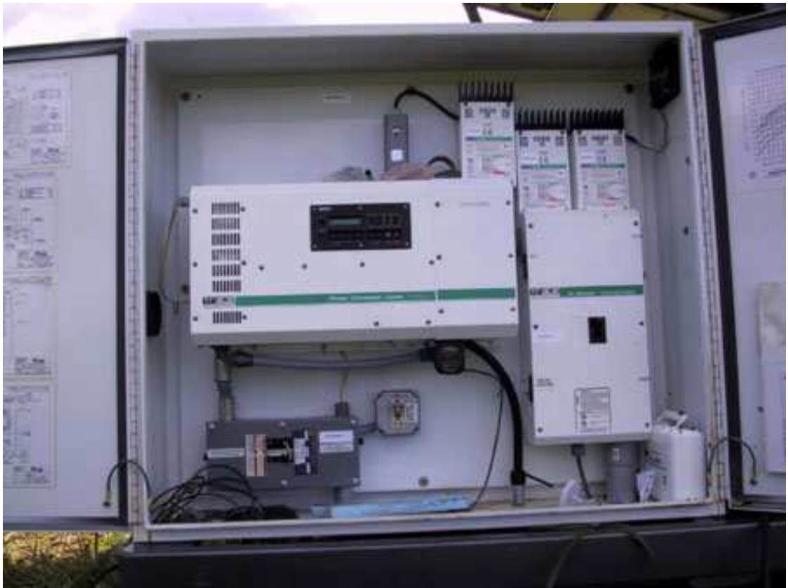
Figura 10: Sistema de Energia Solar Híbrido, SunWize, Inc. Hybrid Power System .
