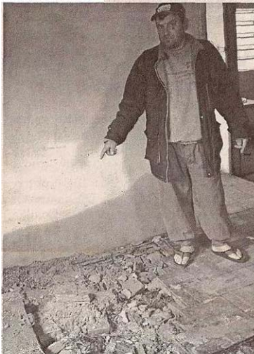
Piso desmoronando com a chuva
