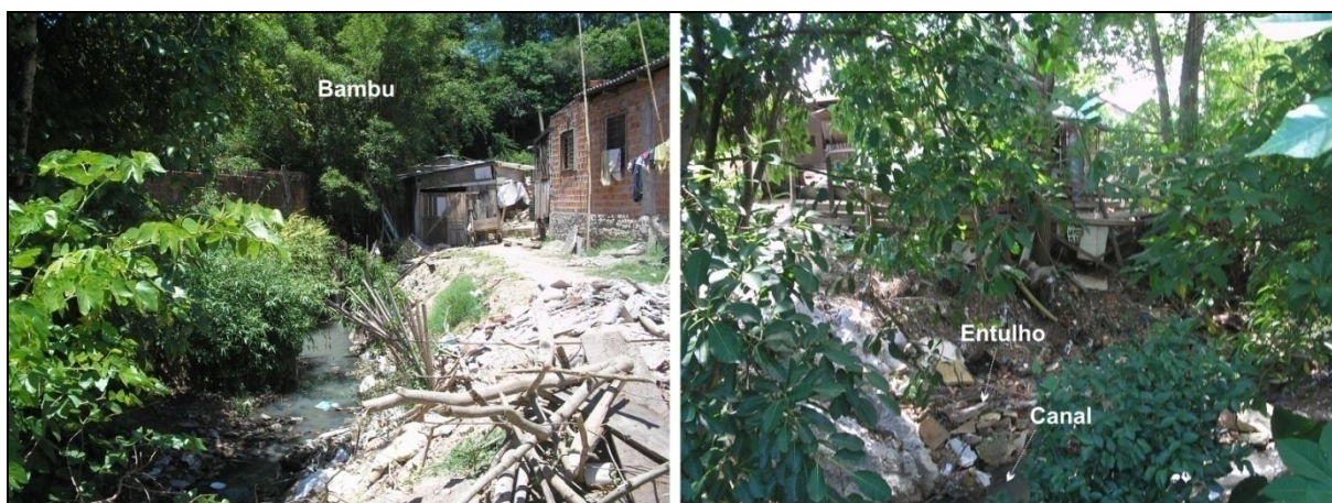
Figura 11 - Exemplo de segmentos de canais sem obras estruturais. Ambas as figuras retratam situações no Arroio Sanga do Hospital e representam segmentos com obras estruturais a montante e/ou a jusante. A) Na margem esquerda a erosão de margem, e a possibilidade de inundação, colocam em risco a residência, localizada muito próxima ao canal; na margem esquerda um muro protege o terreno. Presença de bambu e de lixo e esgoto no canal. B) Segmento de canal com erosão de margem comprometendo residência. Na margem de erosão têm-se depósitos de restos da construção civil.
