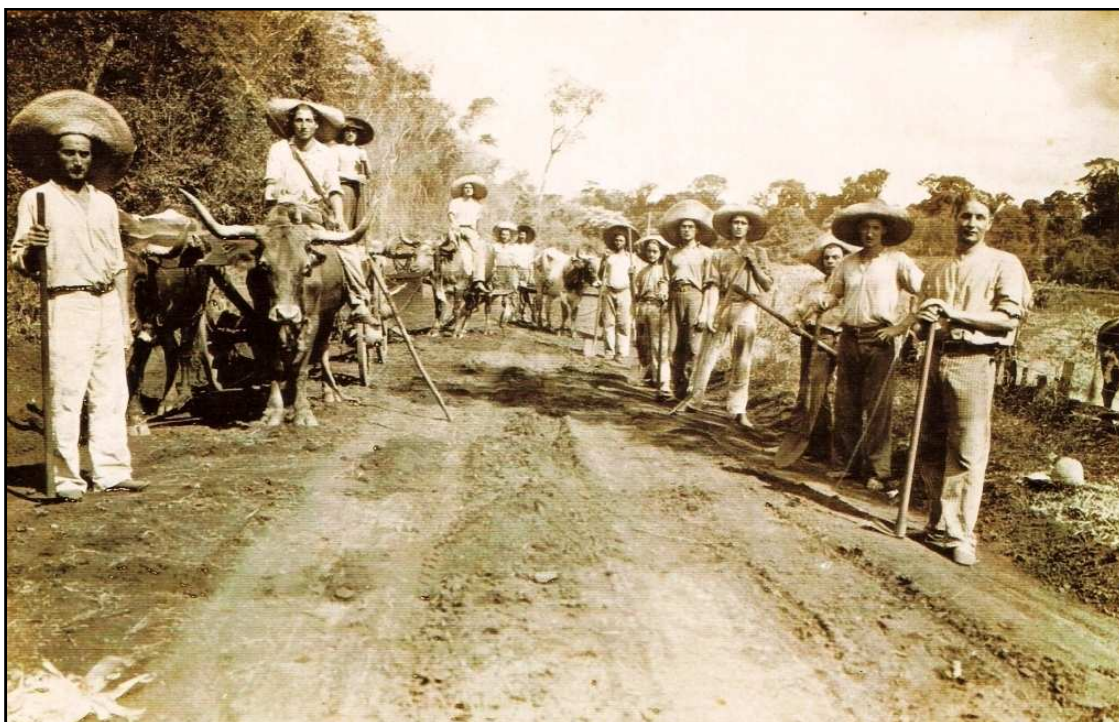
Figura 22: Mutirão para a abertura de estradas em meados da década de 30. A fotografia demonstra o uso de instrumentos simples (simples se comparados às tecnologias posteriores), como enxadas e pás. Aparecem 13 (treze) homens, trabalhadores jovens, com vigor ao trabalho, dispostos em construir o espaço usando tão somente a força muscular e a tração animal. Ao fundo, a mata em que a estrada avança e na direita, a “produção de terra” 27 já efetivada. A construção de estradas era uma das condições básicas para o progresso.
