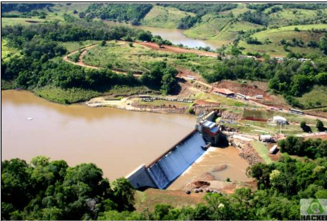
Figura 62: Pequena Central Hidrelétrica (PCH) Santo Antônio localizada no rio Santa Rosa. A vista desta PCH possibilita identificar a intensa transformação da paisagem no entorno do empreendimento, em especial no que se refere à redução da vegetação ciliar. A construção de uma PCH transforma a paisagem com características essencialmente culturais com introdução de elementos estranhos ao espaço natural como estradas e construções.
