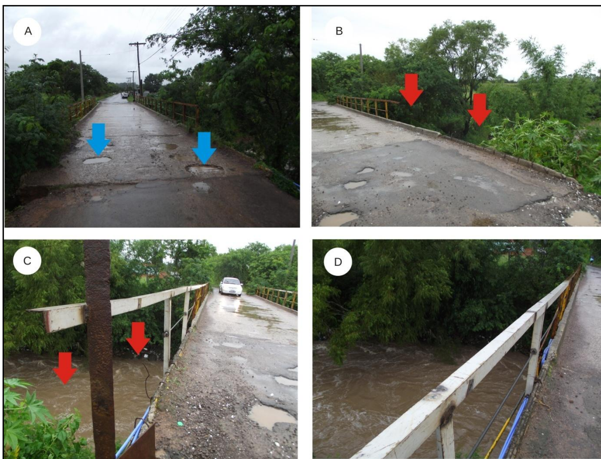
Figura 41 – Ponte de acesso ao bairro Renascença, onde as setas azuis na Figura A indicam os buracos, e as setas vermelhas (Figuras B e C) mostram a precariedade das guardas da ponte, o que representa um grande perigo. Ainda na Figura C, identifica-se que a ponte possui largura que comporta apenas um veículo por vez. Na Figura D é possível observar parte da guarda que ainda se mantém conservada. Fonte: Fotografias tiradas em campo pela autora em janeiro de 2013.
