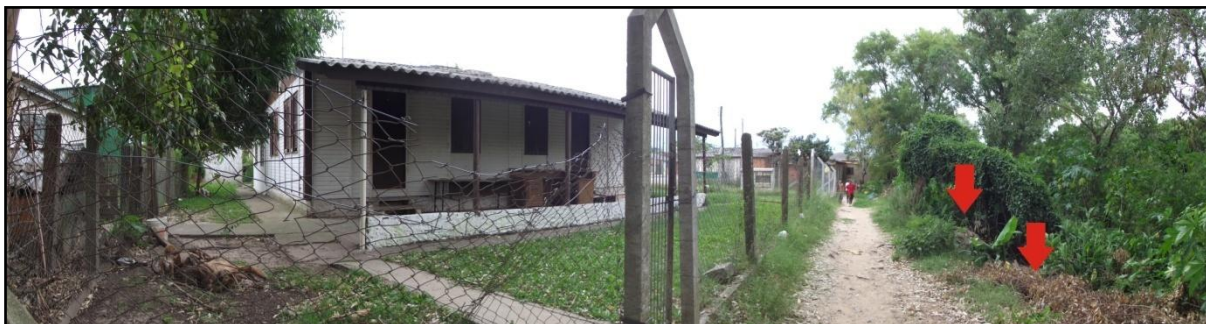
Figura 44 – Associação Comunitária da Vila Renascença, onde as setas vermelhas apontam a preocupante proximidade da erodida margem do Arroio Cadena. Este espaço é cedido à Associação pela Sociedade Vicente Pallotti que, agora, conduz também a antiga Escola Sérgio Lopes.
