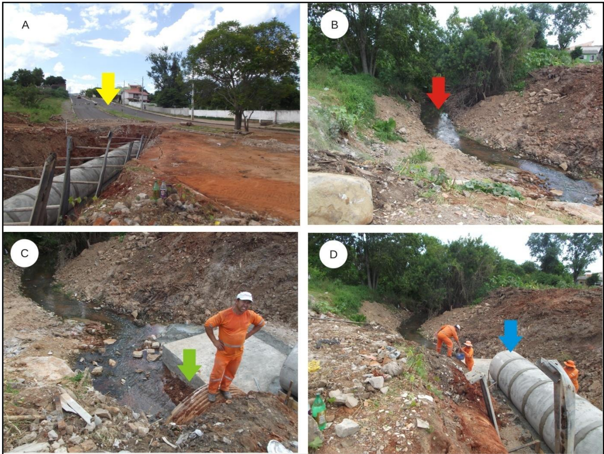
Figura 35 – Obras realizadas na Avenida Liberdade, indicada pela seta amarela na Figura A, a fim de complementar a tubulação de escoamento antiga, indicada pela seta verde (Figura C). O novo sistema de tubulação, indicado na Figura D pela seta azul, servirá para aumentar o escoamento da água da Sanga da Aldeia, indicada na Figura B (seta vermelha), especialmente em dias chuvosos, evitando alagamentos. Foto: Fotografias tiradas em campo pela autora em janeiro de 2013.
