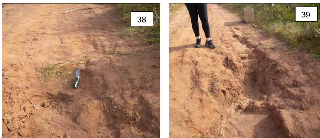
Figura 38 e 39: Vista do primeiro degrau, com direção do E5 ao E6 ao E8. Solapamento e formação de degrau.
