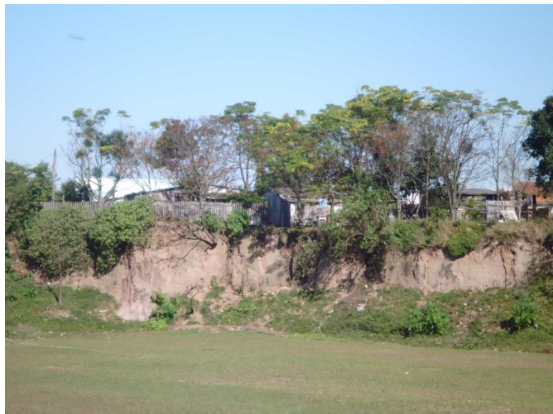
Figura 8 – Residência construída em lugar inadequado na Vila alto da Boa vista.
