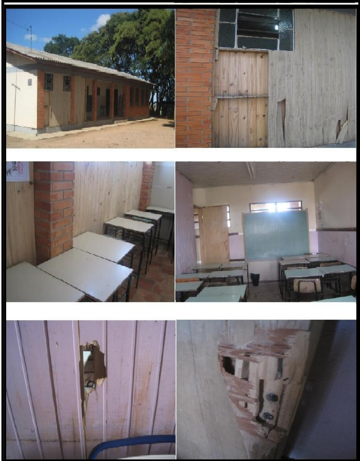
Figura 9 – Mosaico com imagens da infraestrutura da Escola Estadual de Ensino Fundamental Ataliba Rodrigues das Chagas, localizada na área rural do Município de São Gabriel/RS
