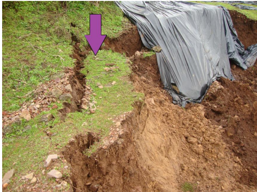
Figura 27: Movimento de massa do tipo escorregamento circular ou rotacional, próximo a torre de transmissão de energia. Org, Vargas, L.
