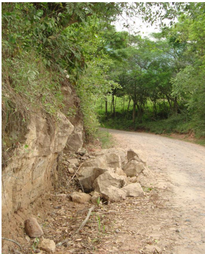
Figura 17: Queda de pequenos blocos. Org. Vargas, L.
