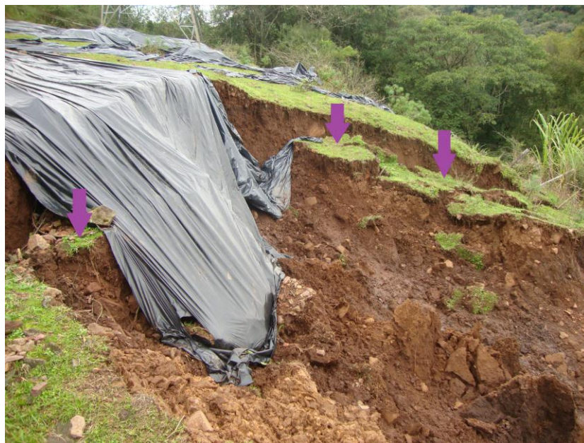
Figura 28: Movimento de massa do tipo escorregamento circular ou rotacional, próximo a torre de transmissão de energia. Org, Vargas, L.
