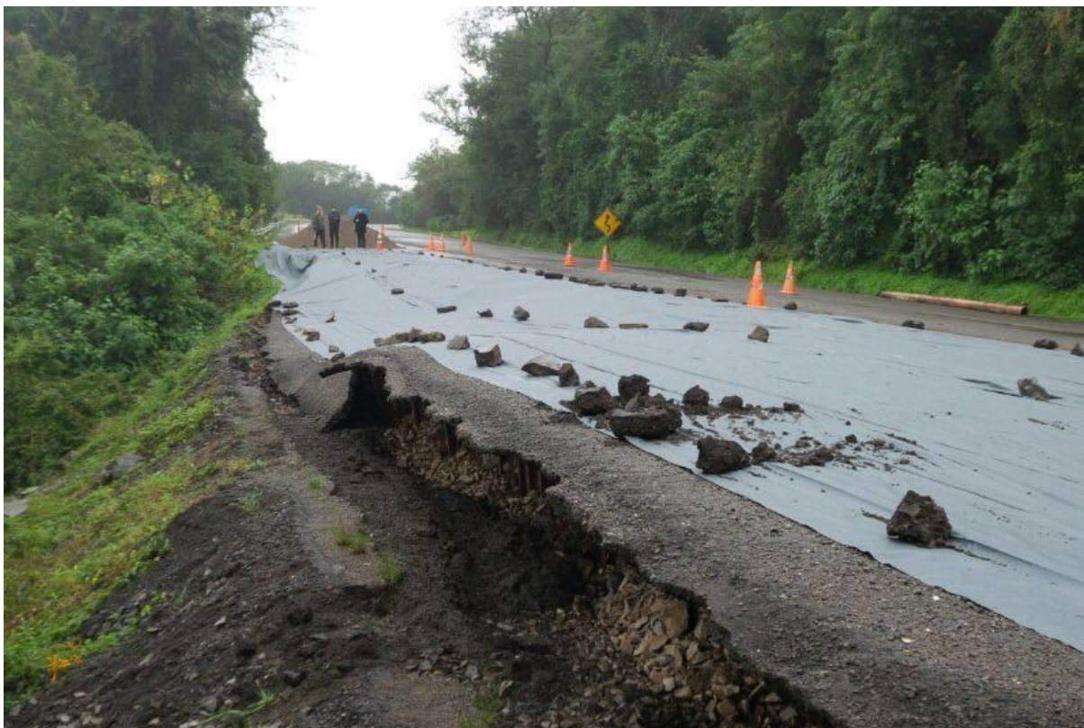
Figura 40: Fotografia da estrada parcialmente bloqueada. Org. Vargas, L.
