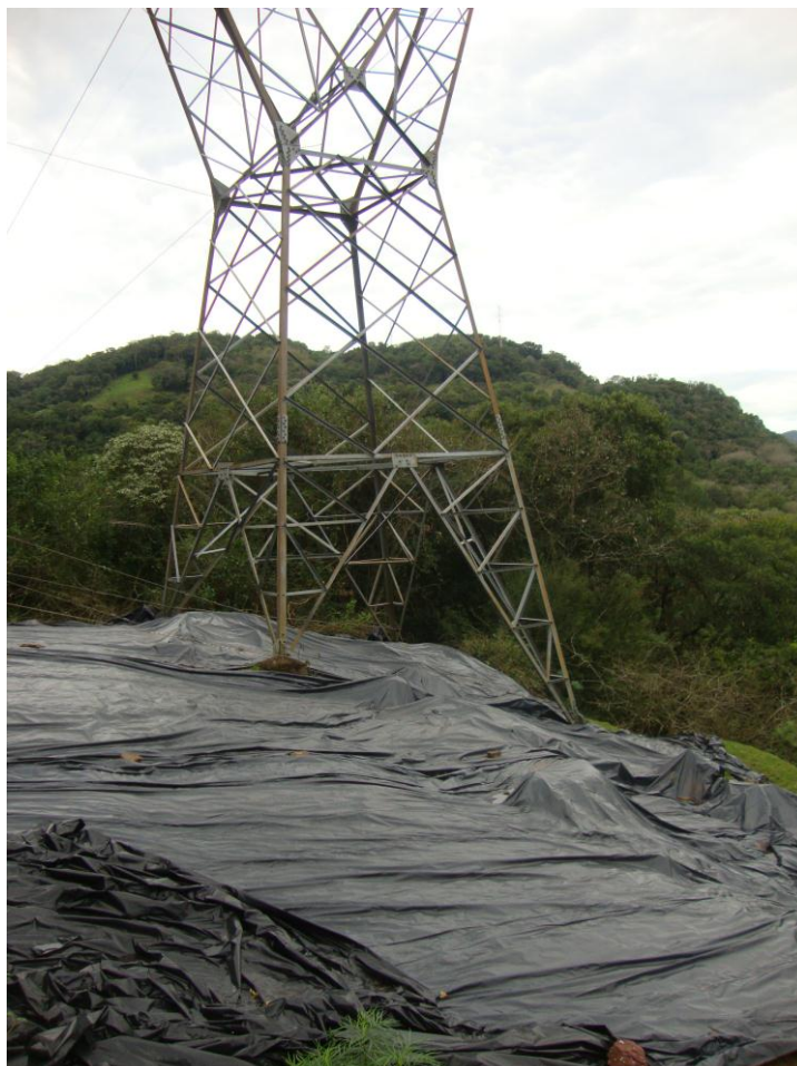
Figura 26: Torre de transmissão de energia. Org. Vargas, L
