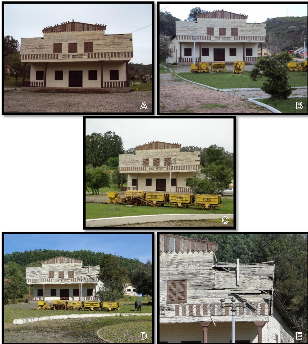
Figura 12 – Mosaico de imagens da depreciação do Cine Rodeio com o passar dos anos. Figuras A e B – Datam de jul. 2012; Figura C – Data de nov. 2013; Figuras D e E – Datam de maio 2015
