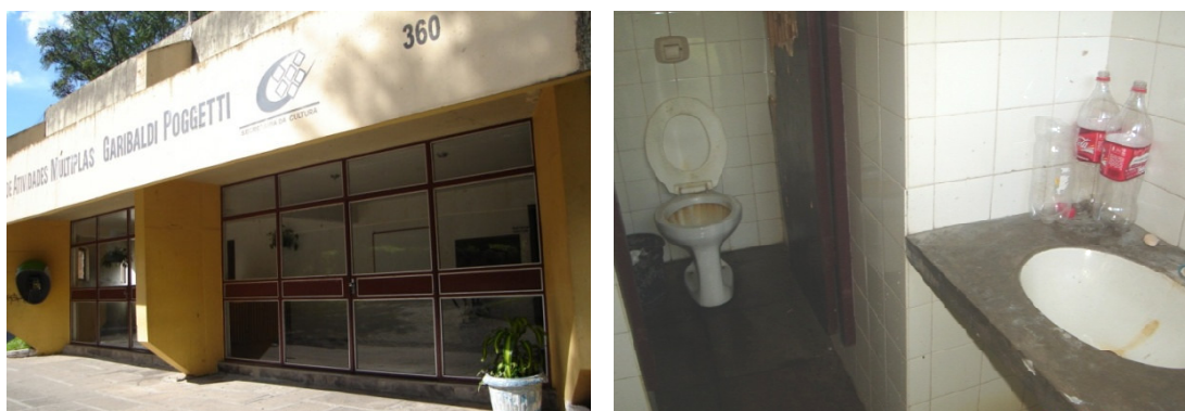
Figuras 46 e 47 – Problema de infra-estrutura: um dos três sanitários existentes no Parque Itaimbé fica no Centro de Atividades Múltiplas, mas este em geral está com as portas cerradas; já o sanitário do quiosque no Setor 5 tem seu uso praticamente impossibilitado pela falta de cuidado e higiene
