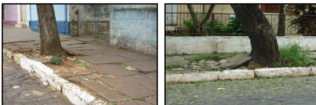
Figura 4.7 - Problemas observados relacionados a quebra de calçadas.
